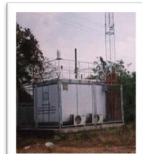
ภาพ สถานีตรวจวัดคุณภาพอากาศ สถานีดับเพลิง เขาน้อย ตำบลปากเพรียว อำเภอเมืองสระบุรี จังหวัดสระบุรี
